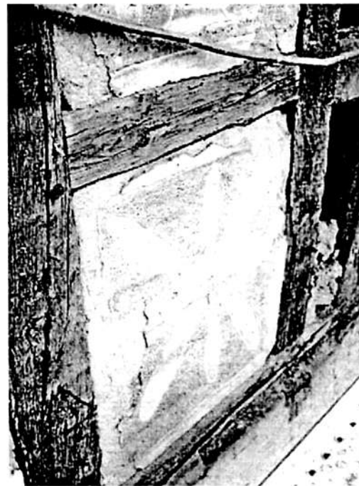
Durch die Entfernung der Eternitverkleidung konnte ein gut erhaltener Stippputz aus dem 18. Jh. freigelegt werden.
